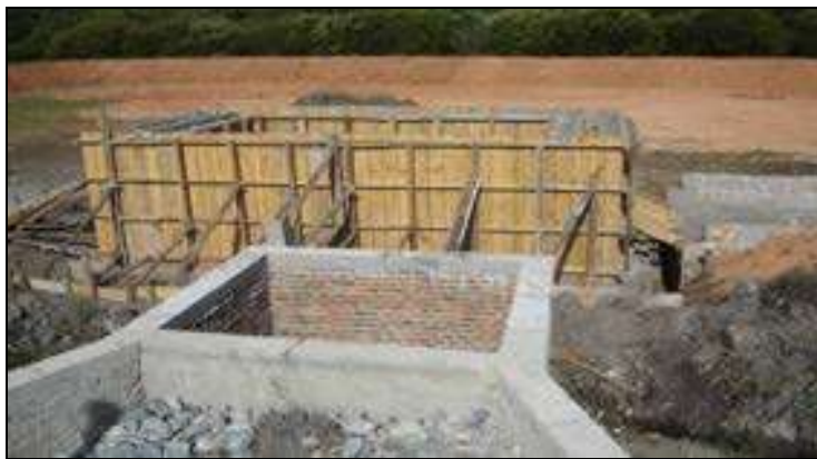
Figura 3.2 – Construção de caixa de passagem e filtro anaeróbio para o sistema de tratamento de lixiviado
