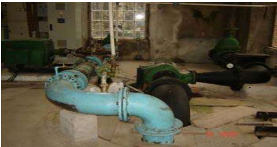
Ilustração 13 - Motores, bombas, tubulação e poço de sucção
