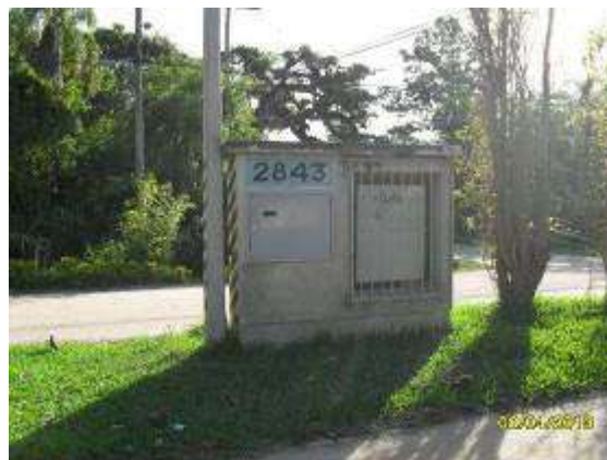
Quadro de comando ELE - L2. (Fonte SANEP)
