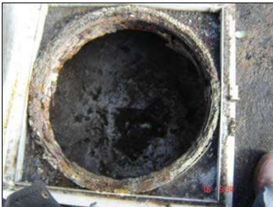
Figura 20 - Caixa de inspeção na parte superior do reator (Fonte STE)
