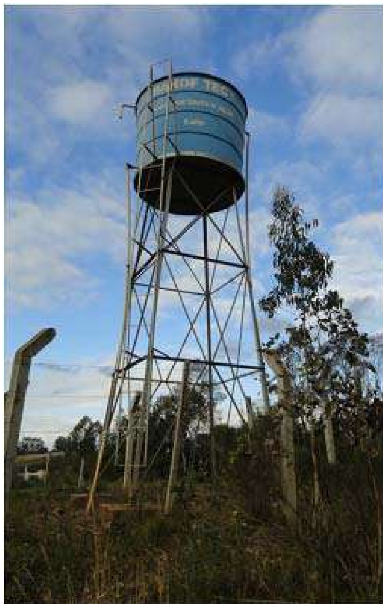
Ilustração 022 – Logo em seguida, uma caixa d'água de 5.000 litros é abastecida, indiretamente, pelo MB-3, servindo, também, como amortecimento de energia da água. Possui tubulações de entrada e saída com mesmo diâmetro, ambas DN 50.
