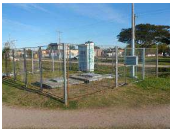
Local da Elevatória Meneghetti. (Fonte SANEP).
