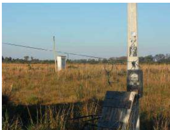
Quadro de comando ELE – Ceval. (Fonte SANEP)
