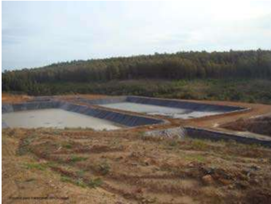
Figura 3.43 – Lagoas de estabilização para tratamento dos lixiviados
