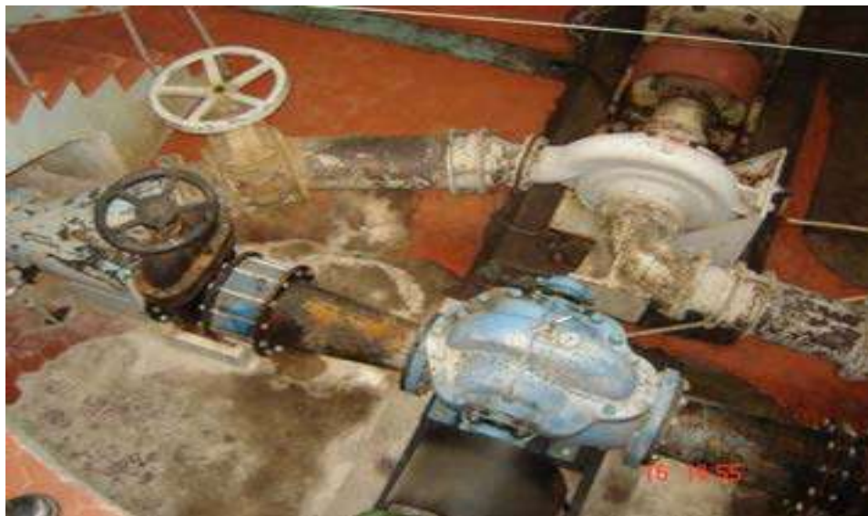
Ilustração 31 - Conjunto motobomba 3ª EEAT
