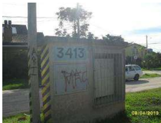
Quadro de comando ELE - L1. (Fonte SANEP)
