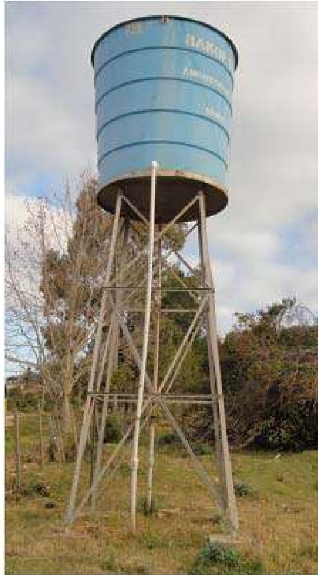
Ilustração 021 – Primeira caixa d'água abastecida pelo MB-3, servindo, também, como amortecimento de energia da água. Possui capacidade de 10.000 litros e tubulações de entrada e saída com mesmo diâmetro, ambas DN 50.
