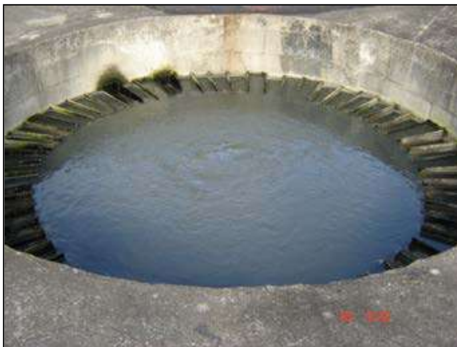
Figura 18 - Chegada do esgoto na parte superior do reator (Fonte STE)
