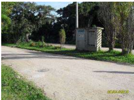
Local da Elevatória L2. (Fonte SANEP)
