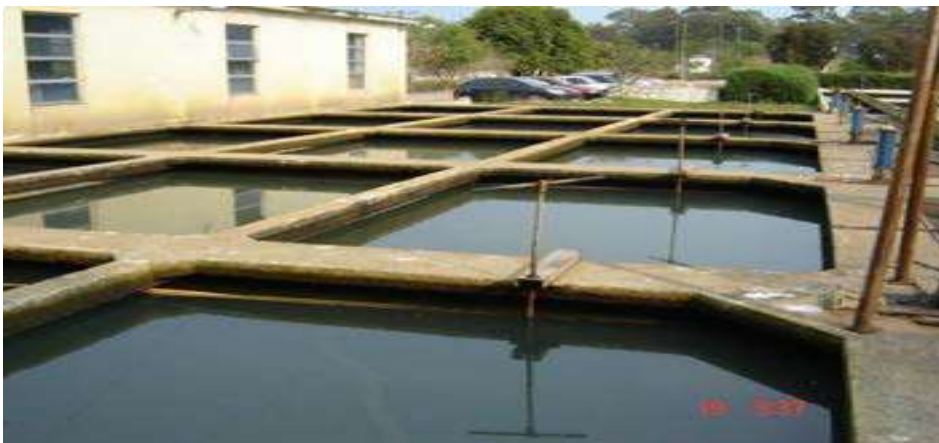
Ilustração 39 - Conjunto de cinco filtros de areia da 1ª etapa
