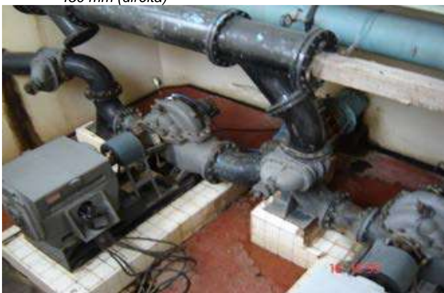
Ilustração 18 - Vista dos conjuntos motobomba 300 mm
