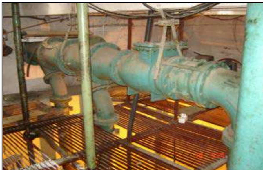
Figura 13 - Barrilete de recalque (Fonte STE)
