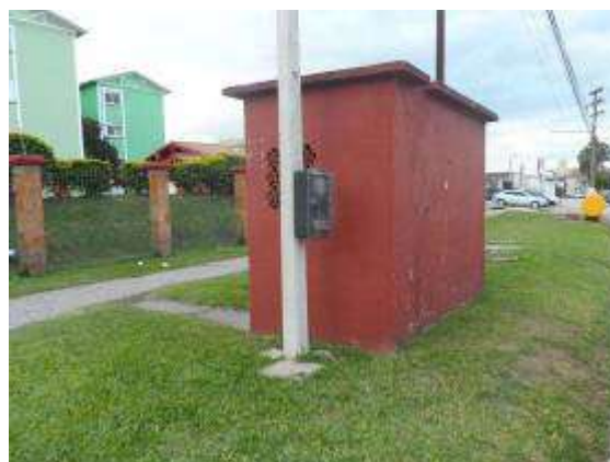
Quadro de comando ELE – Ferreira Viana. (Fonte SANEP)
