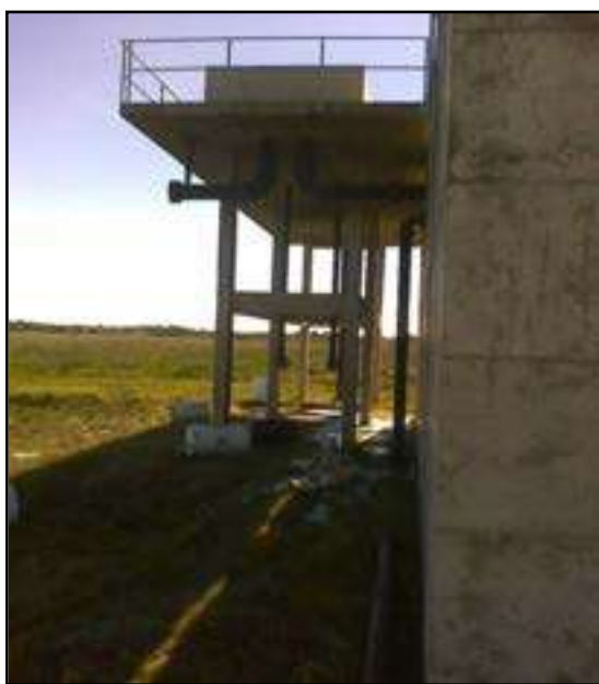
Figura 26 – Desarenador (Fonte STE)
