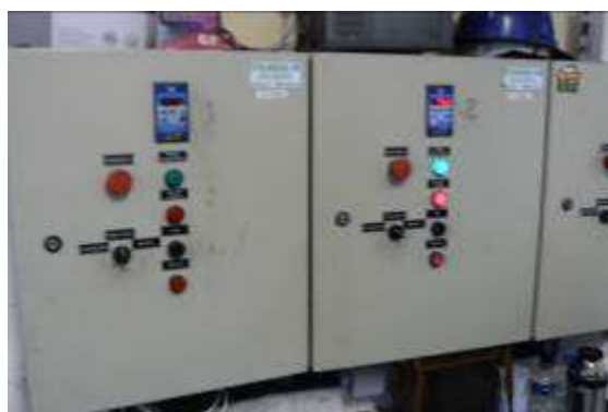
Quadro de comando Elevatória Saldanha Marinho US-II. (Fonte STE)
