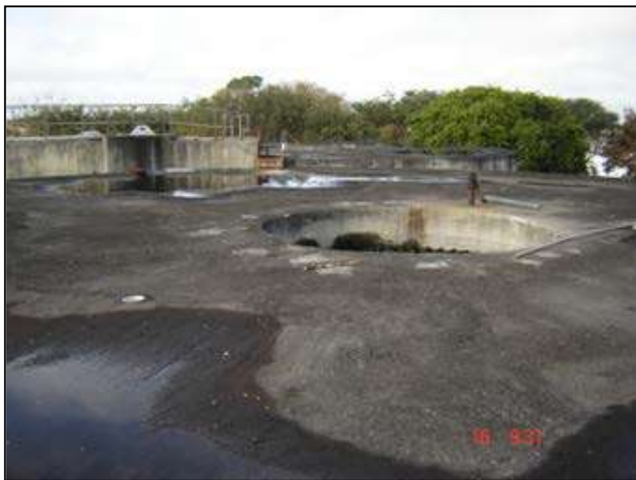
Figura 19 - Vista superior dos reatores (Fonte STE)
