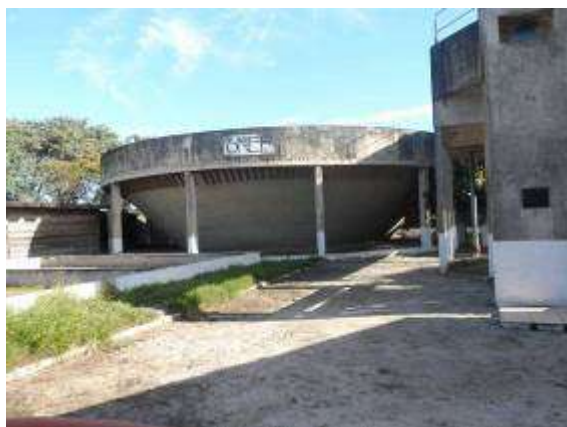
Elevatória US-III - RALF. (Fonte SANEP)
