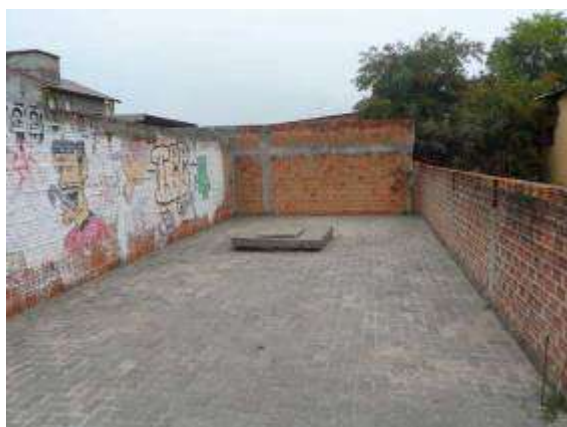
Local da Elevatória Toussaint (desativada). (Fonte SANEP)
