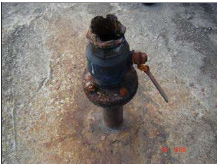
Figura 21 - Queimador de gás desativado (Fonte STE)
