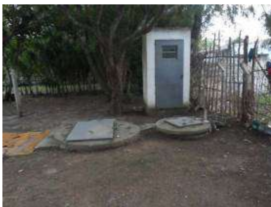
Quadro de comando ELE – Vila Castilho. (Fonte SANEP)
