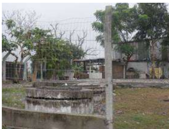
Entrada da ELE – Ceval. (Fonte SANEP)
