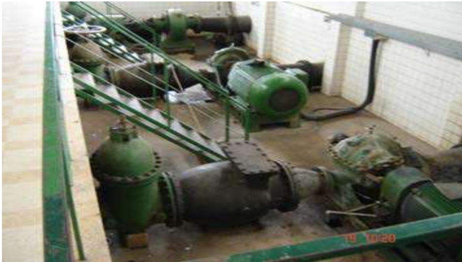
Ilustração 48 - Vista parcial da casa de bombas
