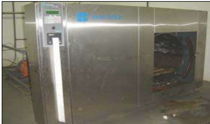
Figura 3.40 – Autoclave para os resíduos sólidos de saúde
