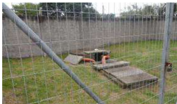
Local da Elevatória Cohab Lindóia. (Fonte SANEP)
