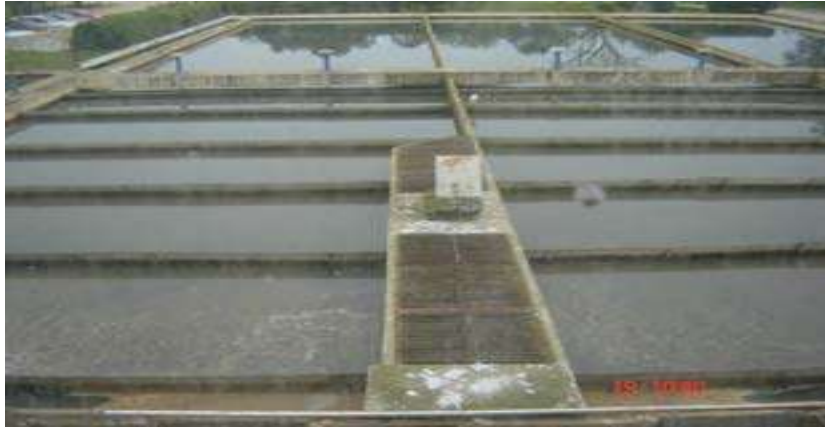
Ilustração 37 – Vista geral dos 06 decantadores da 1ª etapa
