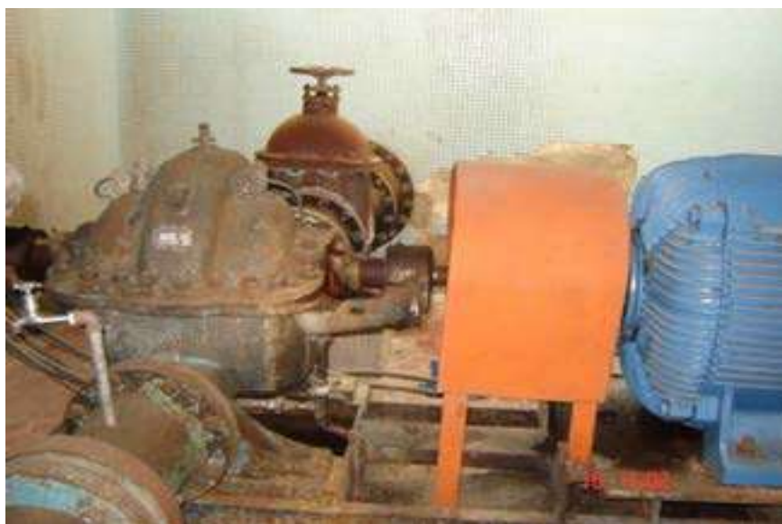
Ilustração 32- Conjunto motobomba 4ª EEAT
