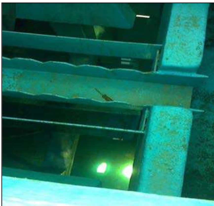
Figura 30 - Calhas internas dos reatores (Fonte STE)
