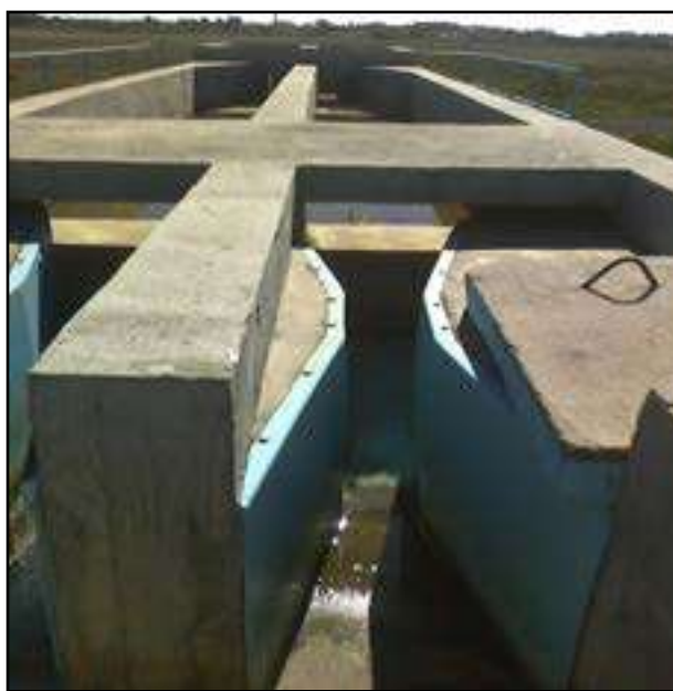
Figura 27 - Calhas Parshall (Fonte STE)
