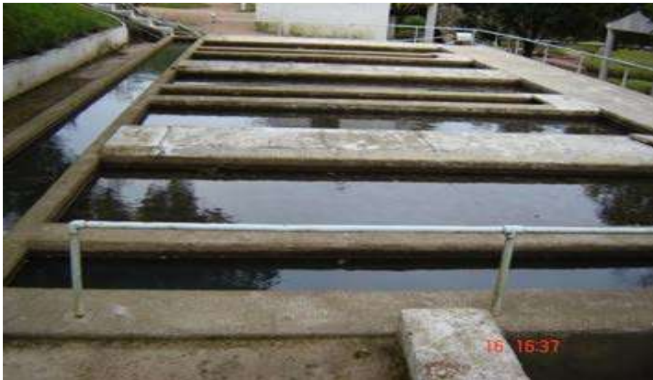
Ilustração 20 - Conjunto de pequenos tanques de filtragem
