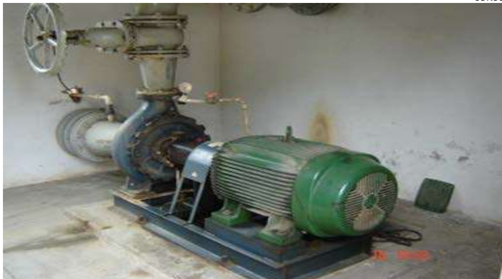
Ilustração 29 - Conjunto motobomba 1ª EEAT
