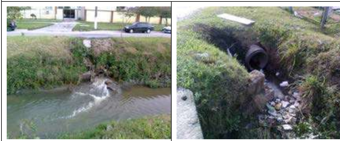
Figura 12: Microdrenagem descarregando na macrodrenagem
