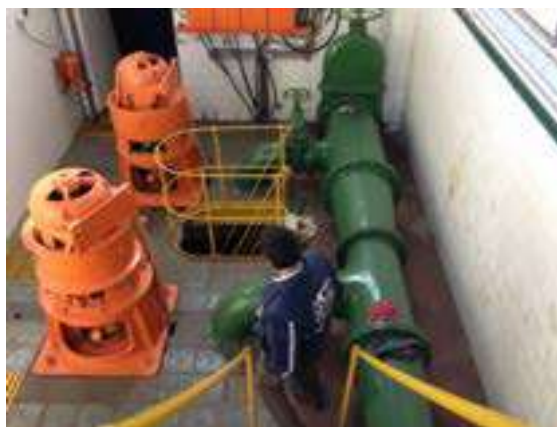
Sistema de bombas ELE – US-I (Fonte STE)
