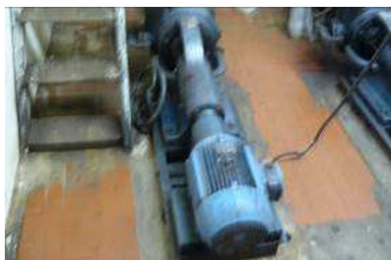
Motores Elevatória Saldanha Marinho US-II . (Fonte STE)
