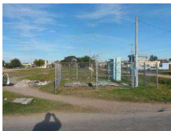
Quadro de comando ELE – Meneghetti. . (Fonte SANEP)
