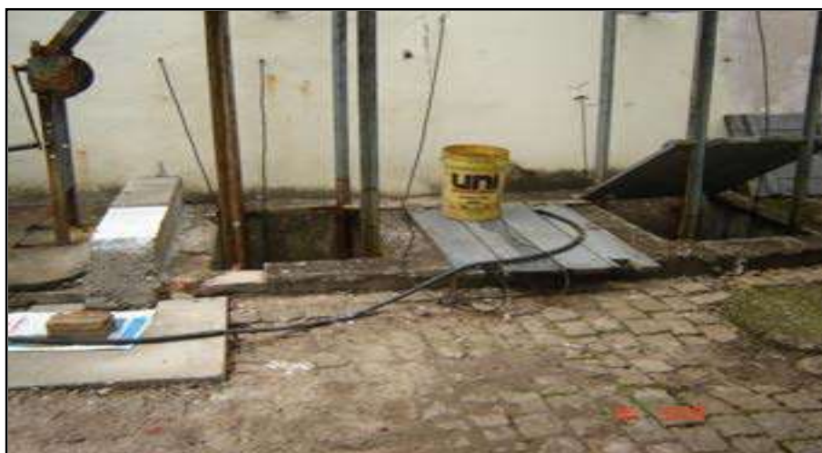
Figura 11 - Chegada do efluente na ETE (Fonte STE)
