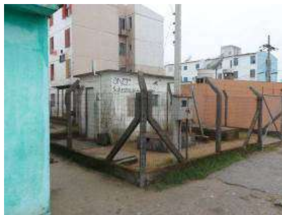
Quadro de comando ELE – Cohab Pestano. (Fonte SANEP)
