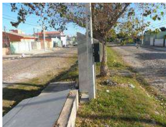
Quadro de comando ELE – Fátima. (Fonte SANEP)
