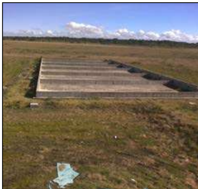
Figura 33 - Leitos de secagem de lodo (Fonte STE)
