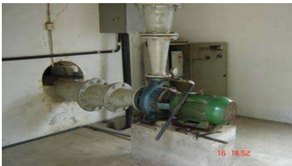
Ilustração 30 - Conjunto motobomba 2ª EEAT
